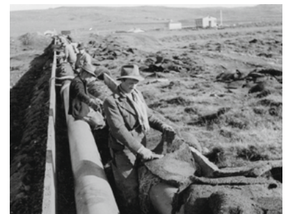
Mikill húsnæðisskortur var í Reykjavík fyrir styrjöldina. Hér leggja starfsmenn hitaveitulagnir árið 1945. Mynd: Orkuveita Reykjavíkur. www.or.is
